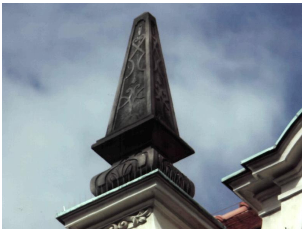
FOT.14. TEATR IM. HELENY MODRZEJEWSKIEJ W LEGNICY. Stan przed konserwacją, kamienna sterczyna z zwieńczenia budynku, widoczna gruba warstwa czarnej patyny i powierzchniowych zabrudzeń.
