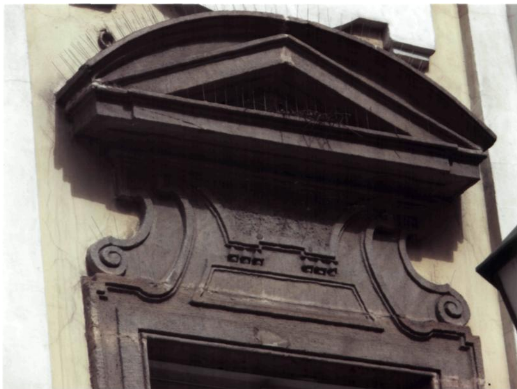
FOT. 10. TEATR IM. HELENY MODRZEJEWSKIEJ W LEGNICY. Stan przed konserwacją, fragment kamieniarki zwieńczenia okna, widoczne powierzchniowe zabrudzenia, przebarwienia spoin, i kitów.
