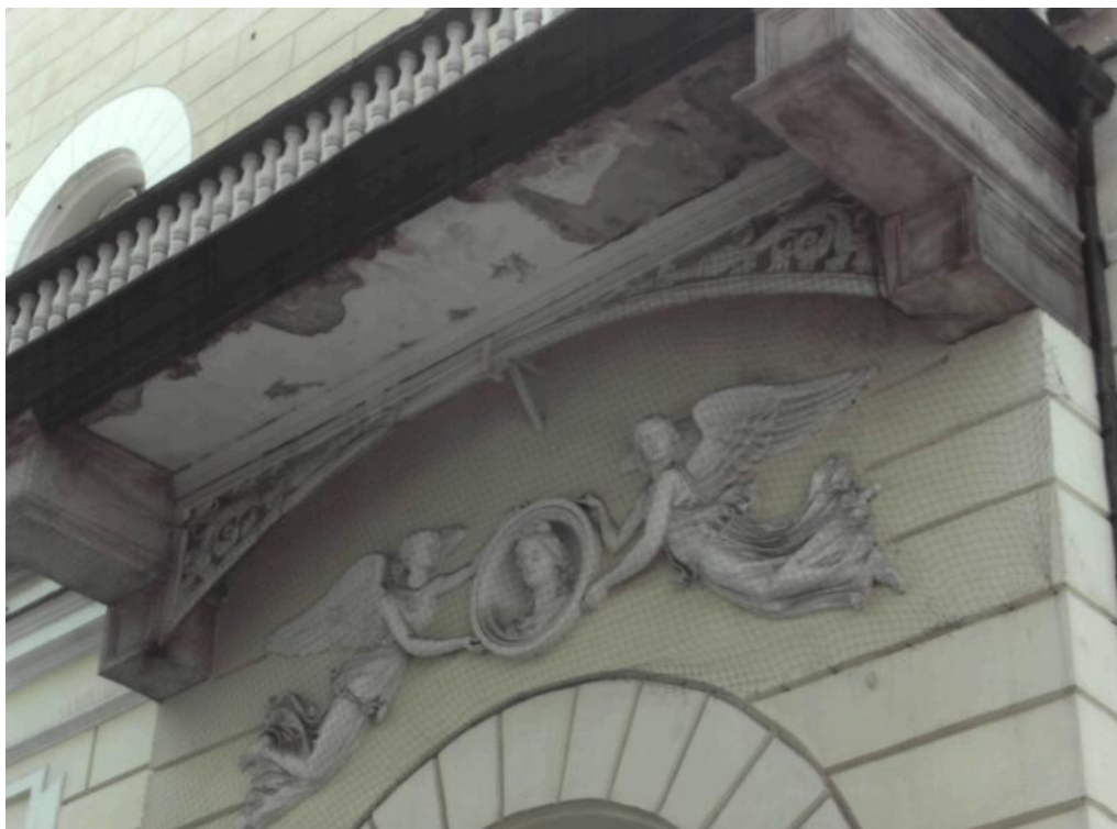
FOT.17. TEATR IM. HELENY MODRZEJEWSKIEJ W LEGNICY. Stan przed konserwacją, balkon z dekoracją sztukatorską, cz. płn.budynku, powierzchnia podestu balkonu przefiltrowana i osłabioną rozległe ubytki.
