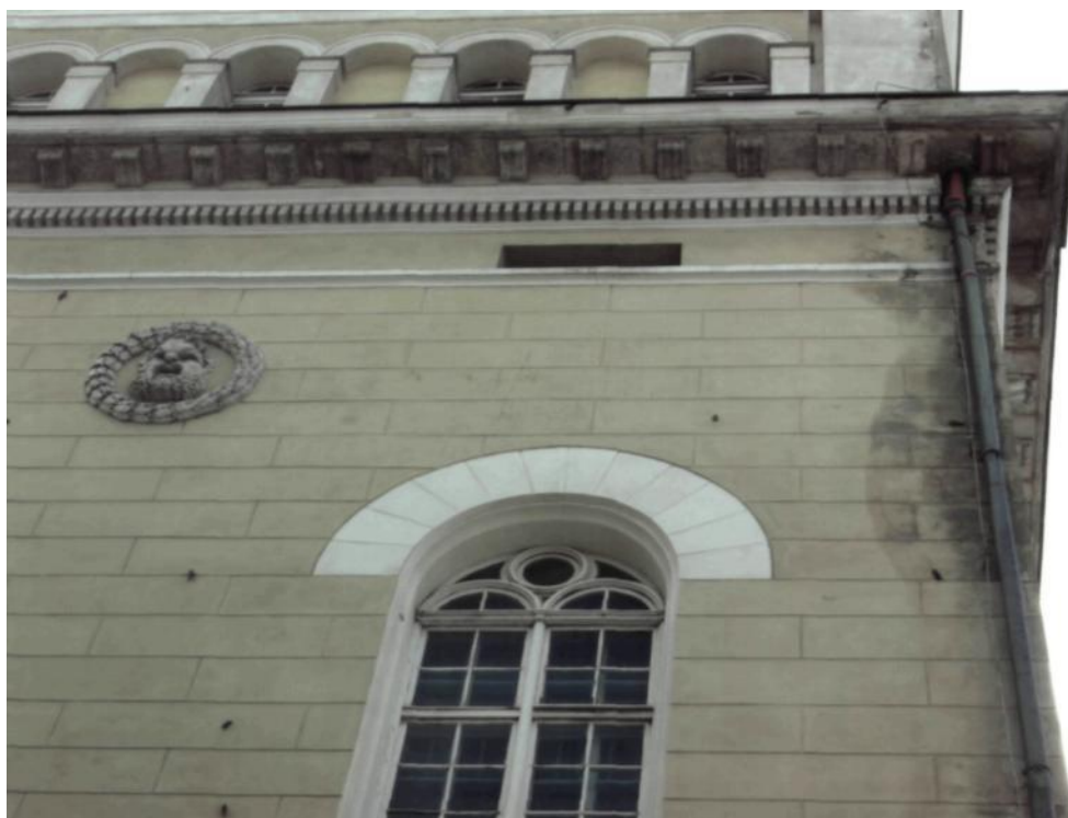
FOT. 16. TEATR IM. HELENY MODRZEJEWSKIEJ W LEGNICY. Stan przed konserwacją, fragment narożnika elewacji północnej, widoczne rozległe zniszczenia tynku i kamieniarki w obrębie gzymsu
