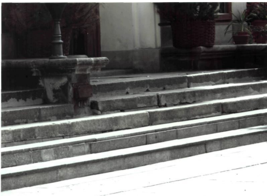
FOT.18. TEATR IM. HELENY MODRZEJEWSKIEJ W LEGNICY. Stan przed konserwacją, fragment kamieniarki schodów w cz. płn.- zach., widoczne powierzchniowe zabrudzenia rozsunięte bloki kamienia.
