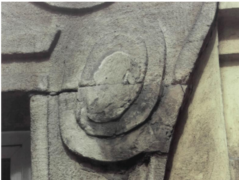
FOT.13. TEATR IM. HELENY MODRZEJEWSKIEJ W LEGNICY. Stan przed konserwacją, fragment kamieniarki zwieńczenia portalu, powierzchniowe zabrudzenia kamienia przebarwienia spoin, i kitów.
