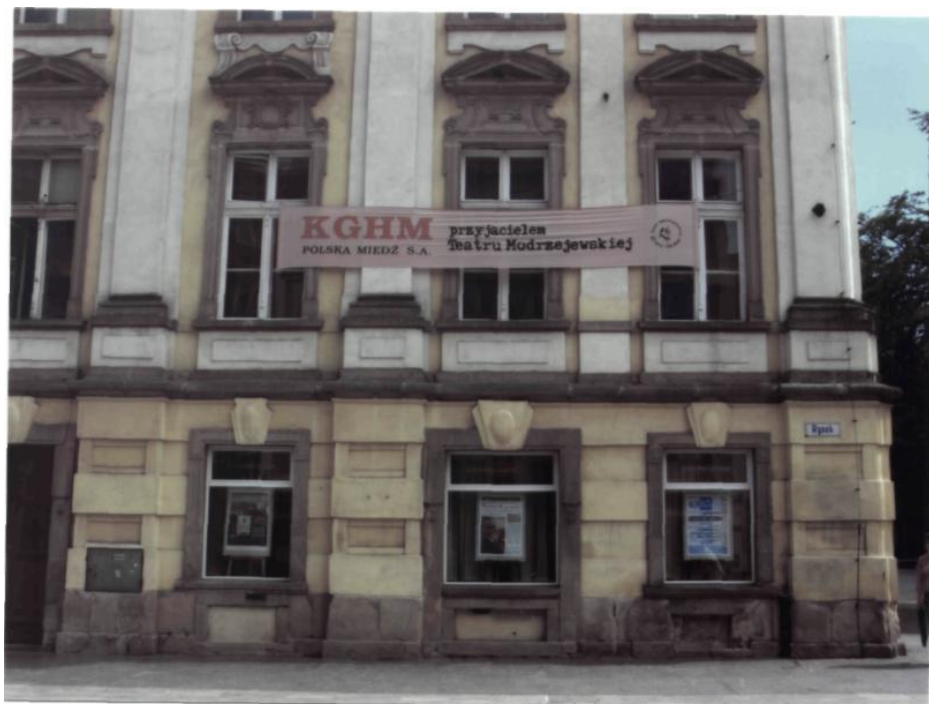
FOT.5. TEATR IM. HELENY MODRZEJEWSKIEJ W LEGNICY. Stan przed konserwacją ujęcie fragmentu elewacji od str. pñ.- zach.. Widoczne zabrudzenia powierzchni obramień kamiennych okien.
