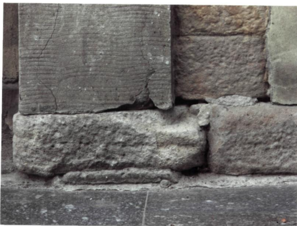
FOT.12. TEATR IM. HELENY MODRZEJEWSKIEJ W LEGNICY. Stan przed konserwacją, fragment kamieniarki cokołu, widoczne powierzchniowe zabrudzenia ubytki, brak spoin, kamień osypuje się.
