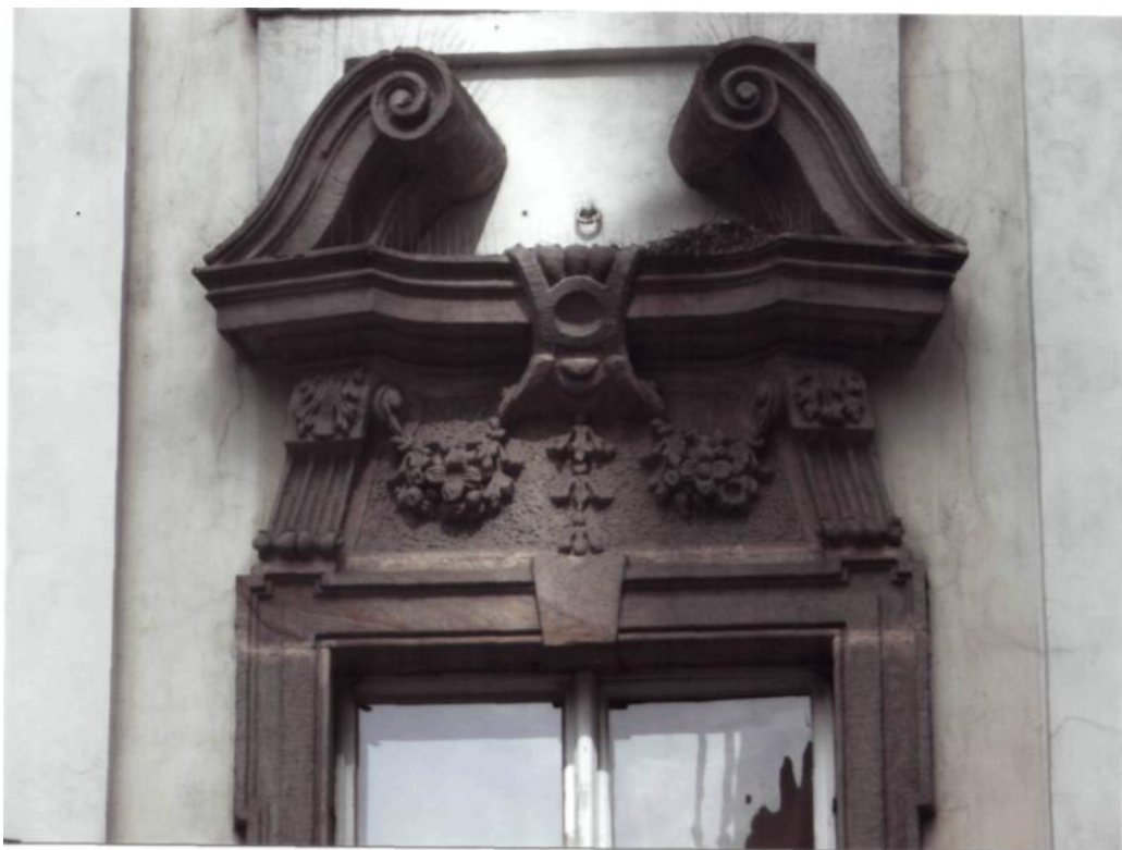
FOT. 9. TEATR IM. HELENY MODRZEJEWSKIEJ W LEGNICY. Stan przed konserwacją, fragment kamieniarki zwieńczenia okna, widoczne powierzchniowe zabrudzenia, przebarwienia spoin, i kitów.
