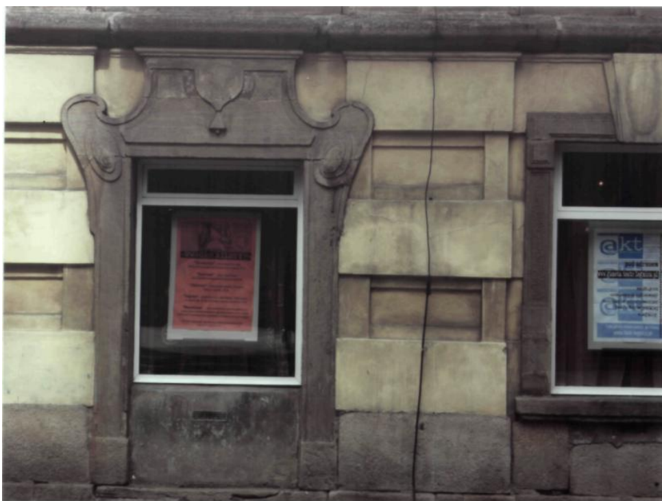
FOT.7. TEATR IM. HELENY MODRZEJEWSKIEJ W LEGNICY. Stan przed konserwacją ujęcie fragmentu elewacji z kamiennym portalem. Powierzchnia kamienia zabrudzona, z tendencją do osypywania.
