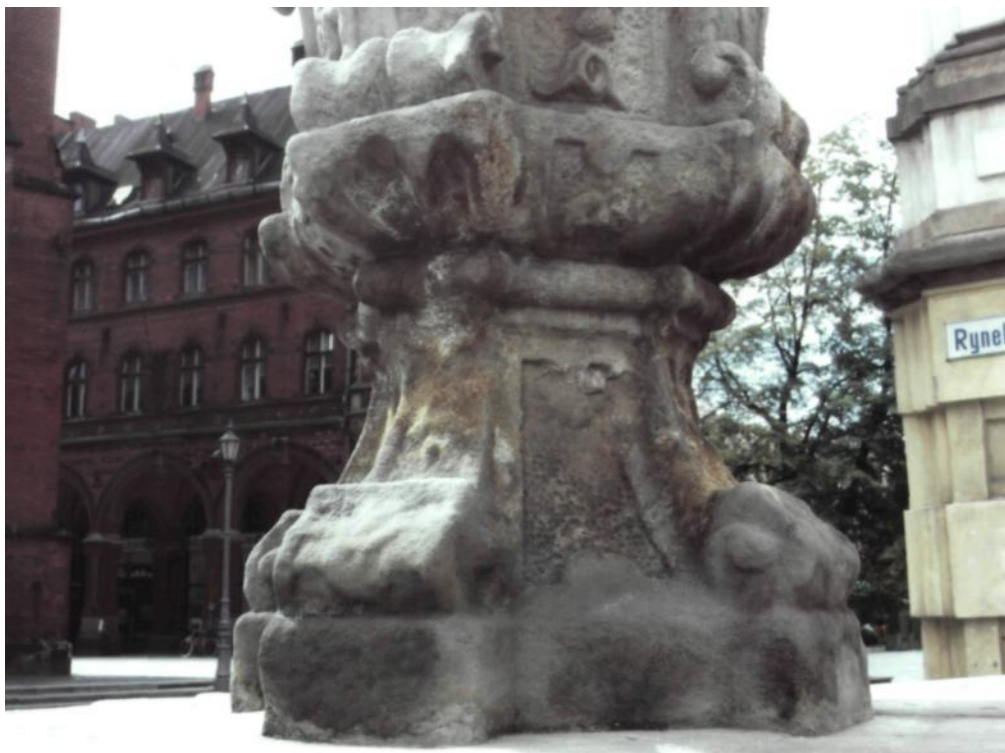
FOT.11. TEATR IM. HELENY MODRZEJEWSKIEJ W LEGNICY. Stan przed konserwacją, fragment kamiennego wazonu z schodów, powierzchnia dekoracji zniszczona, zabrudzona, przebarwiona i zasolona.
