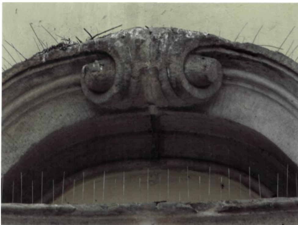
FOT.8. TEATR IM. HELENY MODRZEJEWSKIEJ W LEGNICY. Stan przed konserwacją fragment zwieńczenia okna, zabrudzona pow.
