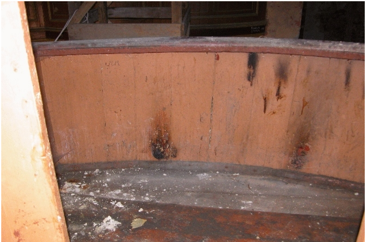
Fot. Nr 42 - Teatr Stary w Lublinie, ul.. Jezuicka18, drewniane łoże, stan zachowania przed rozpoczęciem prac rozbiórkowych. II kondygnacja - łoże. Widok wnętrza balkonu. .Wyk Małgorzata Podgórska - Makal . 03.07. 2007
