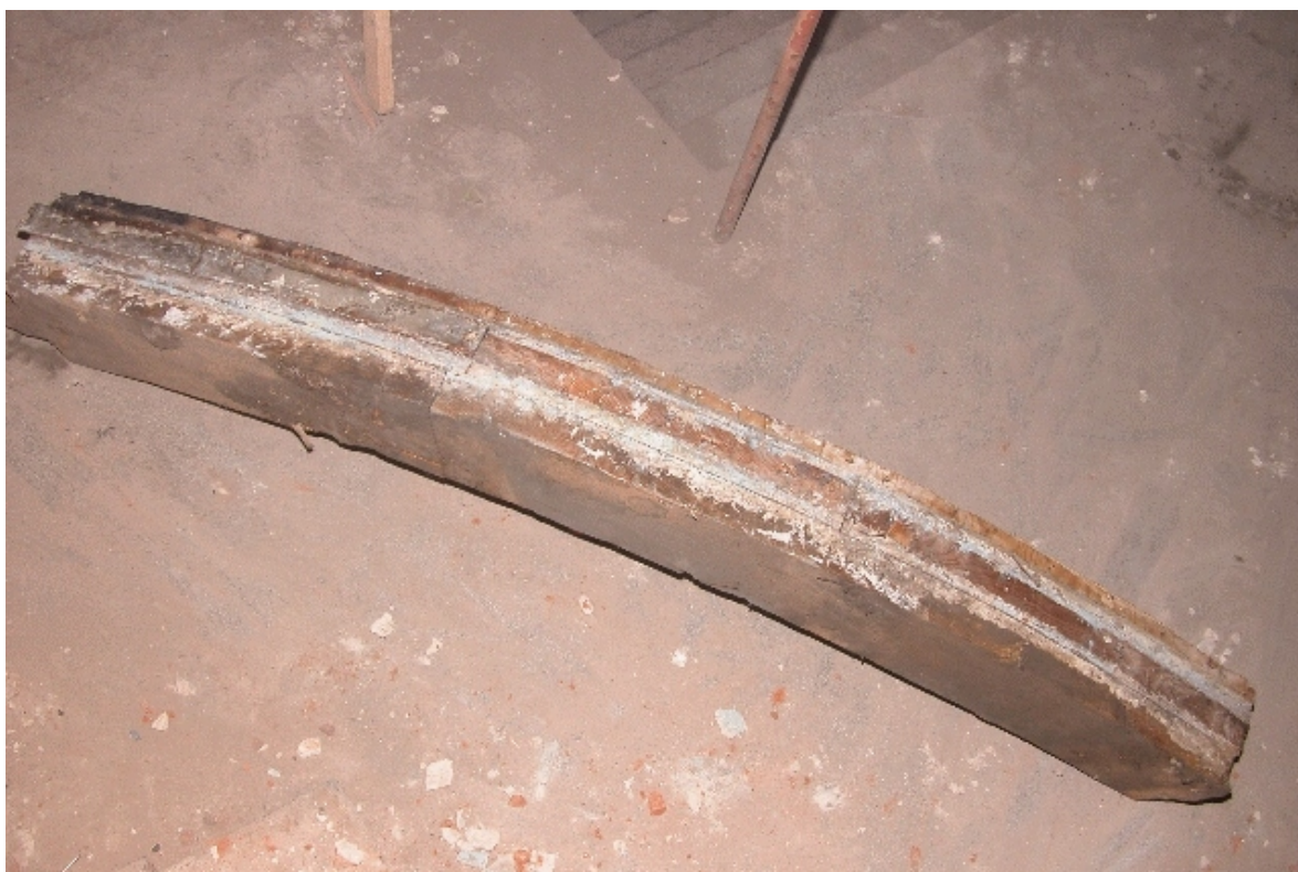
Fot. Nr 88 - Teatr Stary w Lublinie, ul. Jezuicka18,belka okrężna stropu loży II kondygnacji. .Wyk Małgorzata Podgórska - Makal . 09.10. 2007
