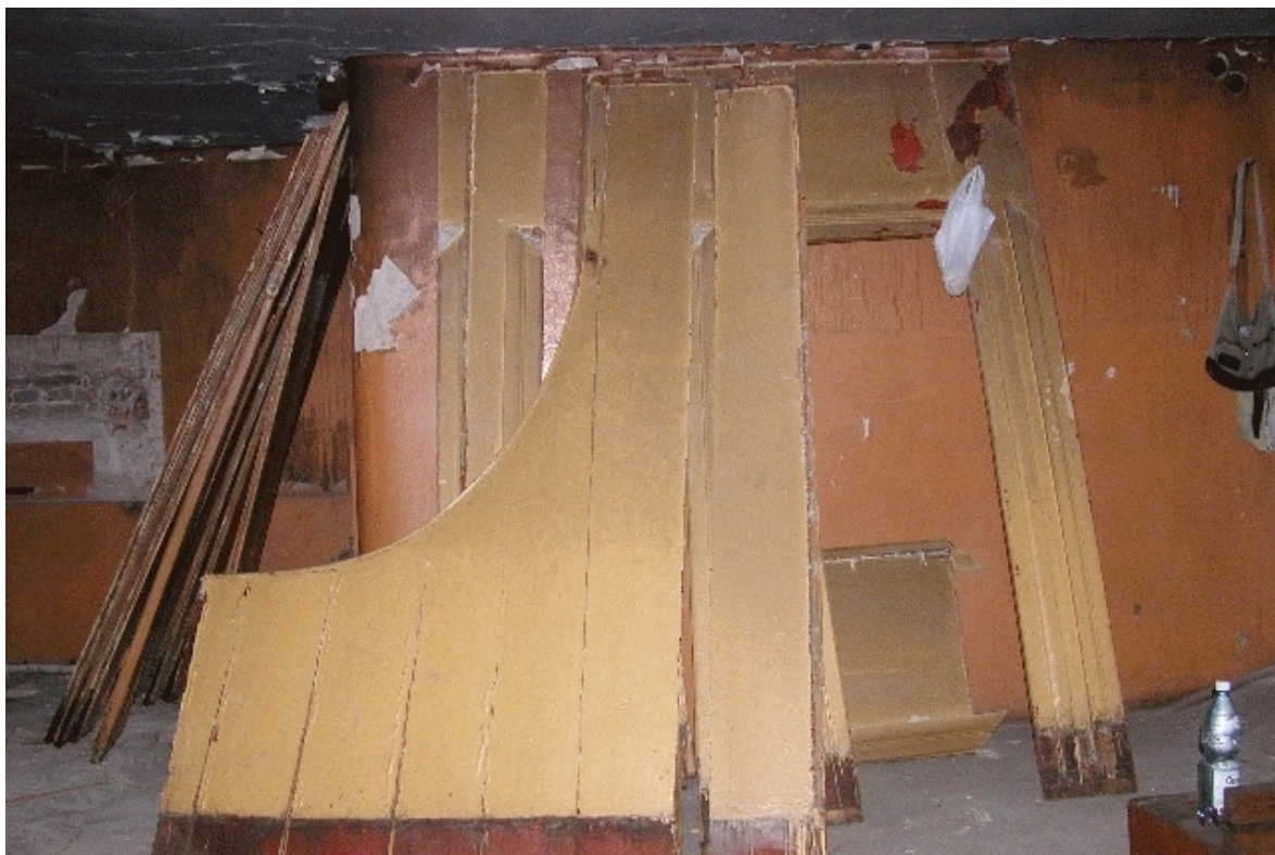
Fot. Nr 73 - Teatr Stary w Lublinie, ul. Jezuicka 18, drewniane loże - II kondygnacja. Stan zachowania ścianek działowych po zdemontowaniu. Wyk Małgorzata Podgórska - Makal . 27.08. 2007
