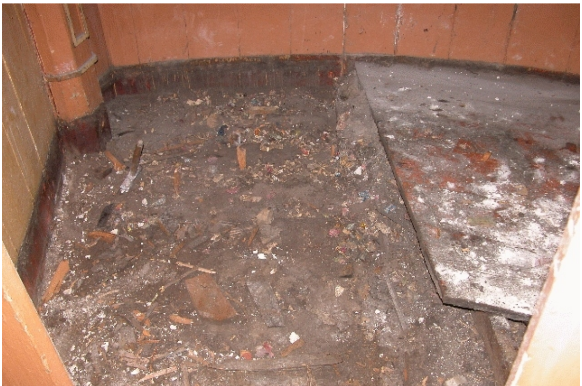
Fot. Nr 62 - Teatr Stary w Lublinie, ul. Jezuicka18,drewniane łoże - II kondygnacja. Stan w czasie rozbierania podestów w łożach .Wyk Małgorzata Podgórska - Makal . 22.08. 2007
