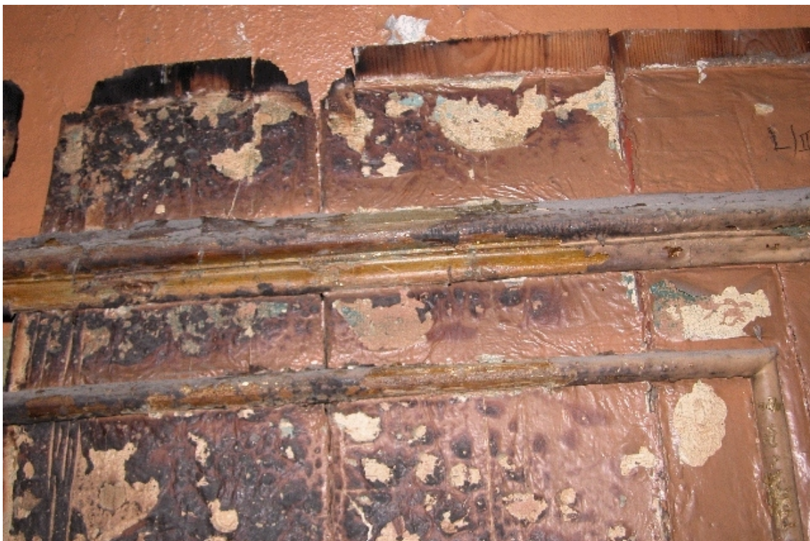
Fot. Nr 76 - Teatr Stary w Lublinie, ul... Jezuicka18,drewniane łoże - II kondygnacja. Nadpalona balustrada balkonu po zdemontowaniu - fragment. Wyk Małgorzata Podgórska - Makal . 27.08. 2007
