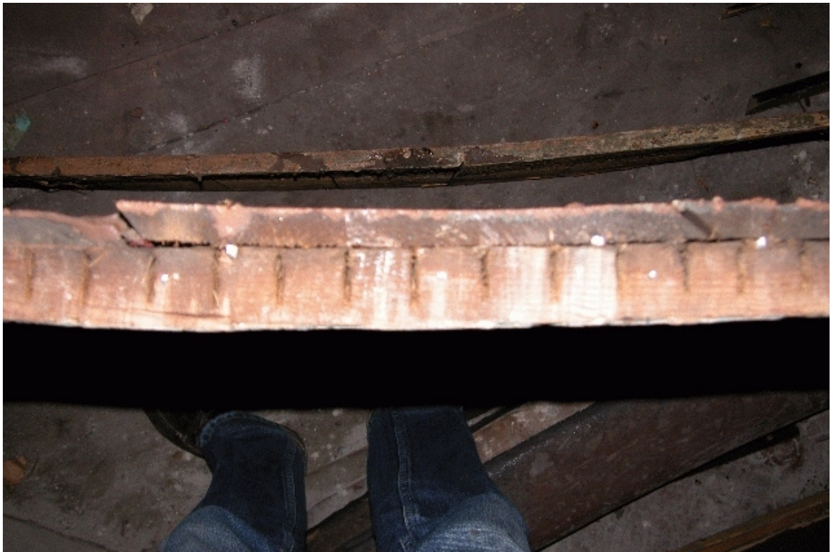
Fot. Nr 77 - Teatr Stary w Lublinie, ul. Jezuicka18, drewniane loże - II kondygnacja. Przekrój panela balkonu po zdemontowaniu. Widoczny sposób wyginania panelu poprzez system nacięć. Wyk Małgorzata Podgórska - Makal . 28.08. 2007
