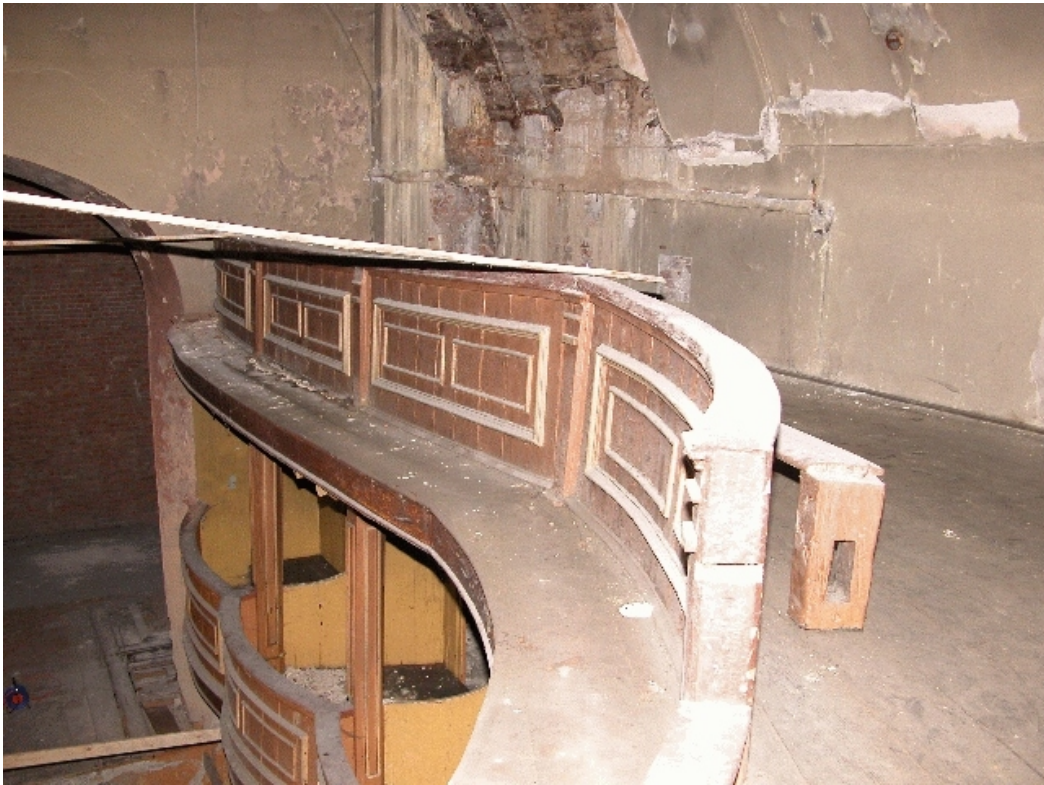
Fot. Nr 3 - Teatr Stary w Lublinie, ul. Jezuicka18,drewniane łoże, stan zachowania przed rozpoczęciem prac rozbiórkowych. III kondygnacja łoż - galeria. Wyk Małgorzata Podgórska - Makal . 03.07. 2007
