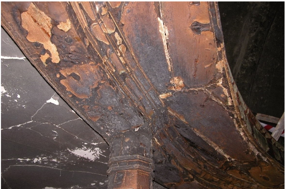
Fot. Nr 78 - Teatr Stary w Lublinie, ul. Jezuicka18, drewniane loże - II kondygnacja. Nadpalony słup i belka okrężna. Wyk Małgorzata Podgórska - Makal . 28.08. 2007
