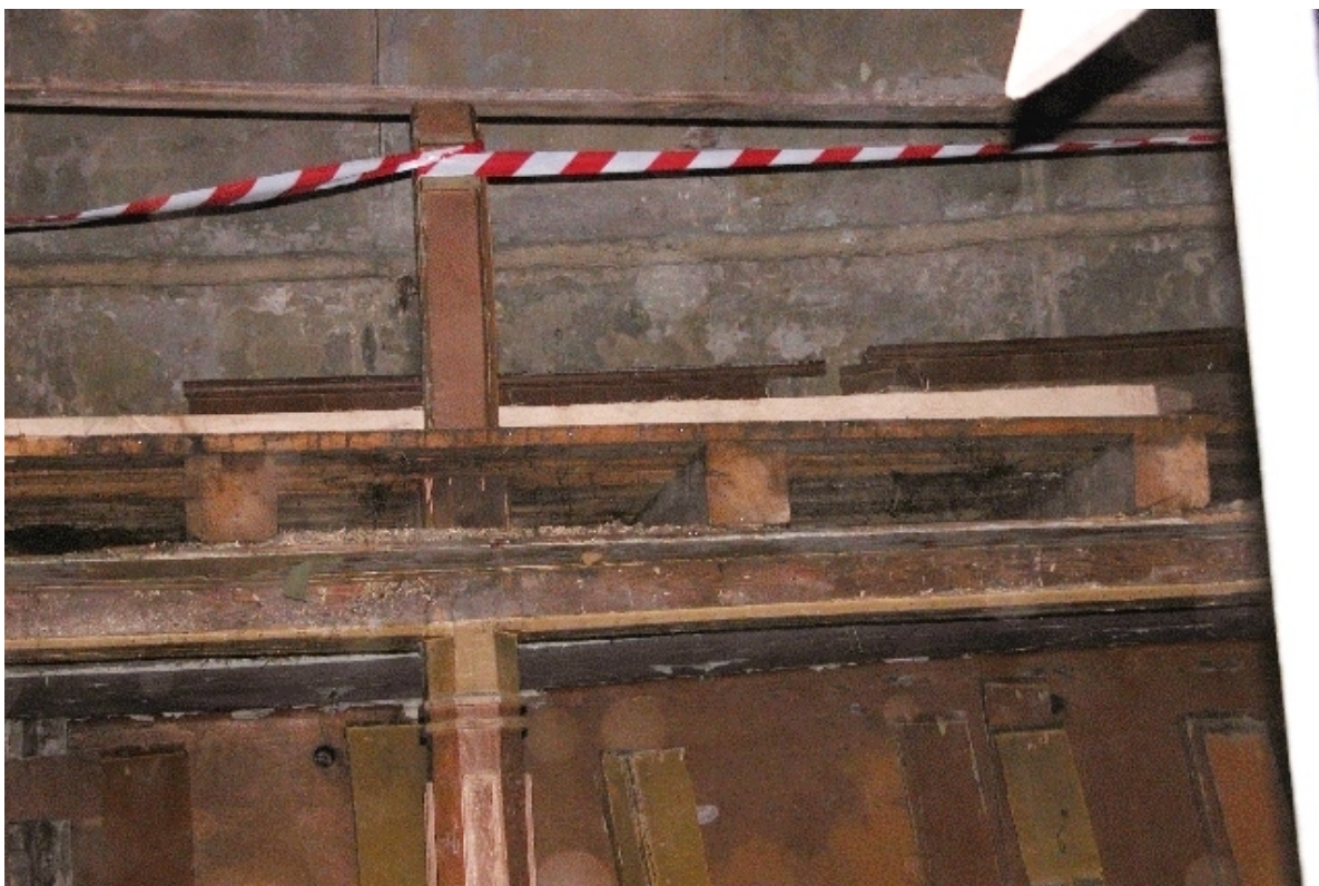
Fot. Nr 72 - Teatr Stary w Lublinie, ul. Jezuicka18,drewniane loże - II kondygnacja. Widoczne belki stropowe po zdemontowaniu obłożenia..Wyk Małgorzata Podgórska - Makal . 27.08. 2007
