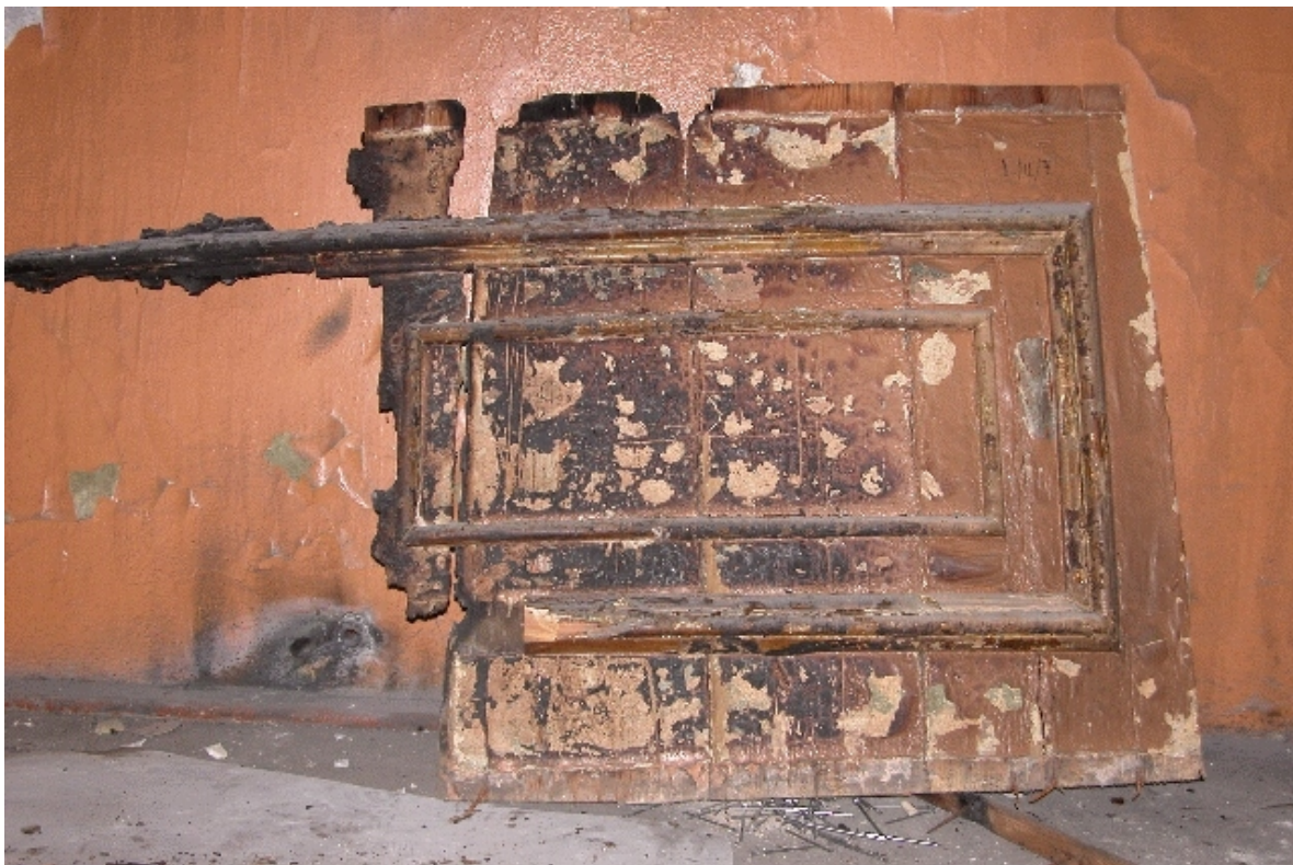
Fot. Nr 75 - Teatr Stary w Lublinie, ul. Jezuicka18,drewniane łoże - II kondygnacja. Nadpalona balustrada balkonu po zdemontowaniu. Wyk Małgorzata Podgórska - Makal . 27.08. 2007
