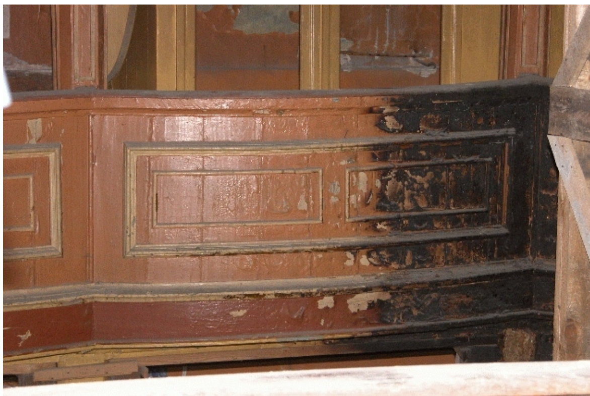
Fot. Nr 24 - Teatr Stary w Lublinie, ul... Jezuicka18,drewniane loże, stan zachowania przed rozpoczęciem prac rozbiórkowych. II kondygnacja - balkony. Widoczne zniszczenia spowodowane pożarem. Wyk Małgorzata Podgórska - Makal . 03.07. 2007
