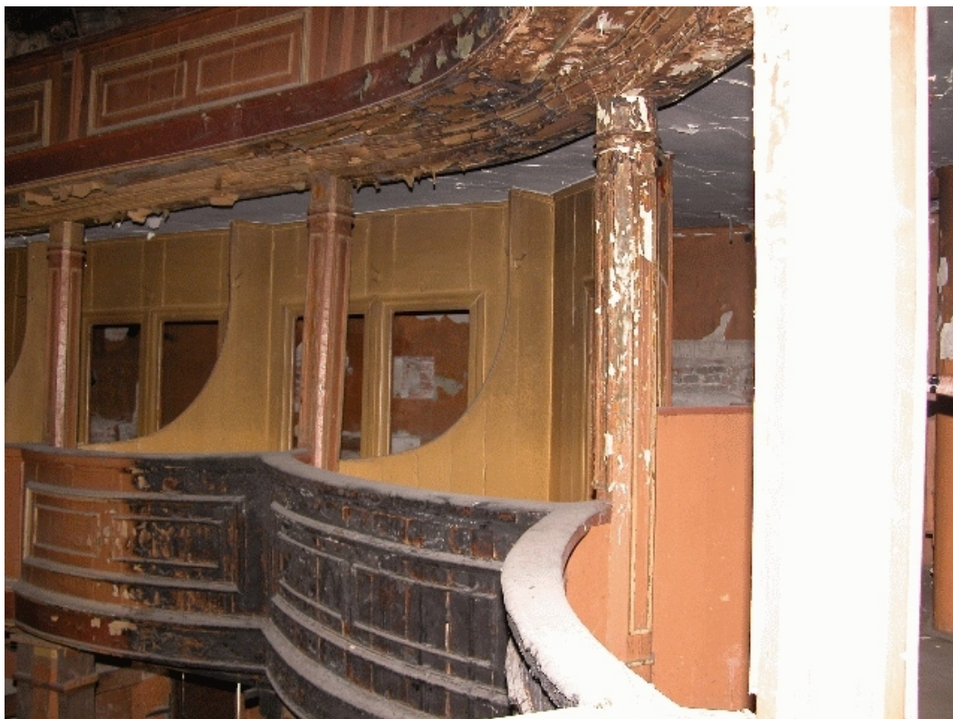
Fot. Nr 23 - Teatr Stary w Lublinie, ul.. Jezuicka18, drewniane loże, stan zachowania przed rozpoczęciem prac rozbiórkowych. II kondygnacja - balkony. Widoczne zniszczenia spowodowane pożarem. Wyk Małgorzata Podgórska - Makal . 03.07. 2007
