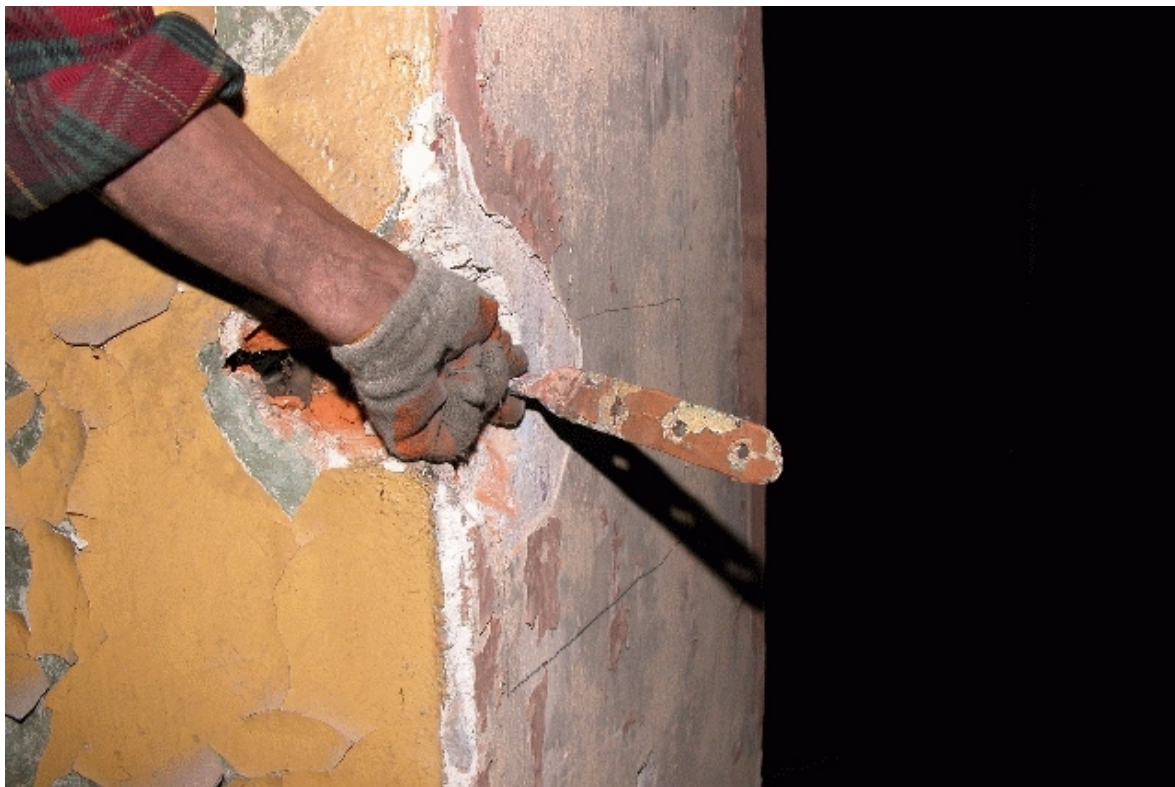
Fot. Nr 65 - Teatr Stary w Lublinie, ul. Jezuicka18,drewniane loże - II kondygnacja łóż. Kotwa i sposób kotwienia zewnętrznej loży. Wyk Małgorzata Podgórska - Makal . 20.08. 2007
