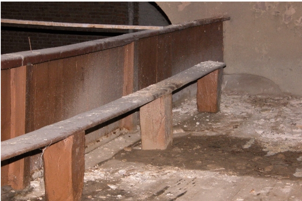
Fot. Nr 16 - Teatr Stary w Lublinie, ul. Jezuicka 18, drewniane łóże, stan zachowania przed rozpoczęciem prac rozbiórkowych. III kondygnacja łóż - galeria. Widok od strony miejsc dla publiczności. I Wyk Małgorzata Podgórska - Makal . 20.08. 2007
