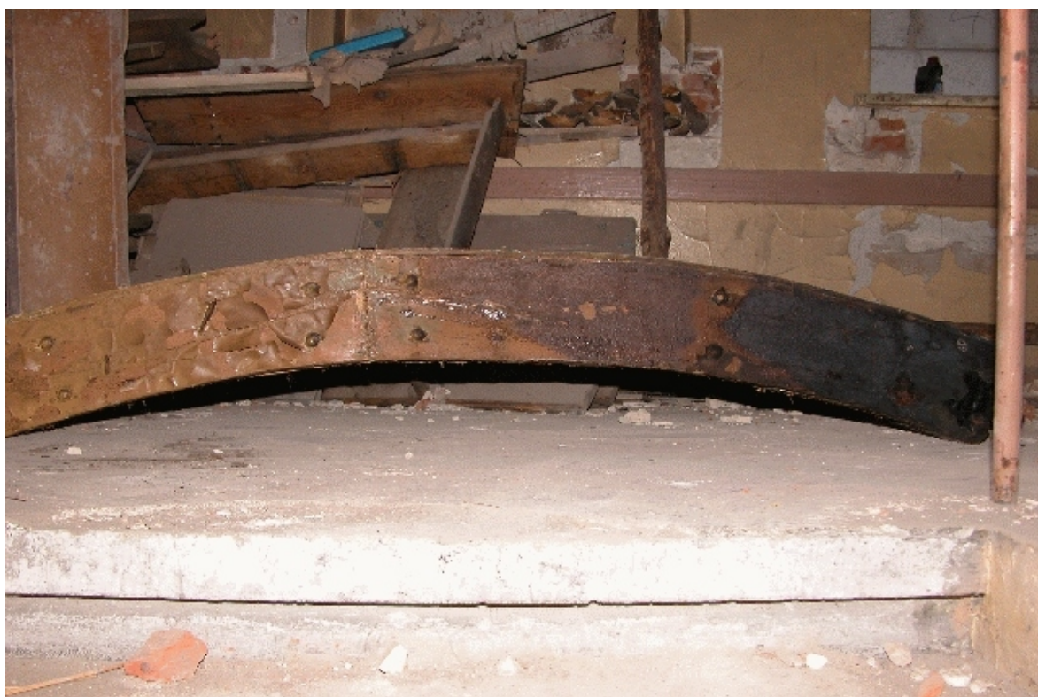
Fot. Nr 89 - Teatr Stary w Lublinie, ul. Jezuicka 18, belka okrężna stropu loży II kondygnacji. .Wyk Małgorzata Podgórska - Makal . 09.10. 2007
