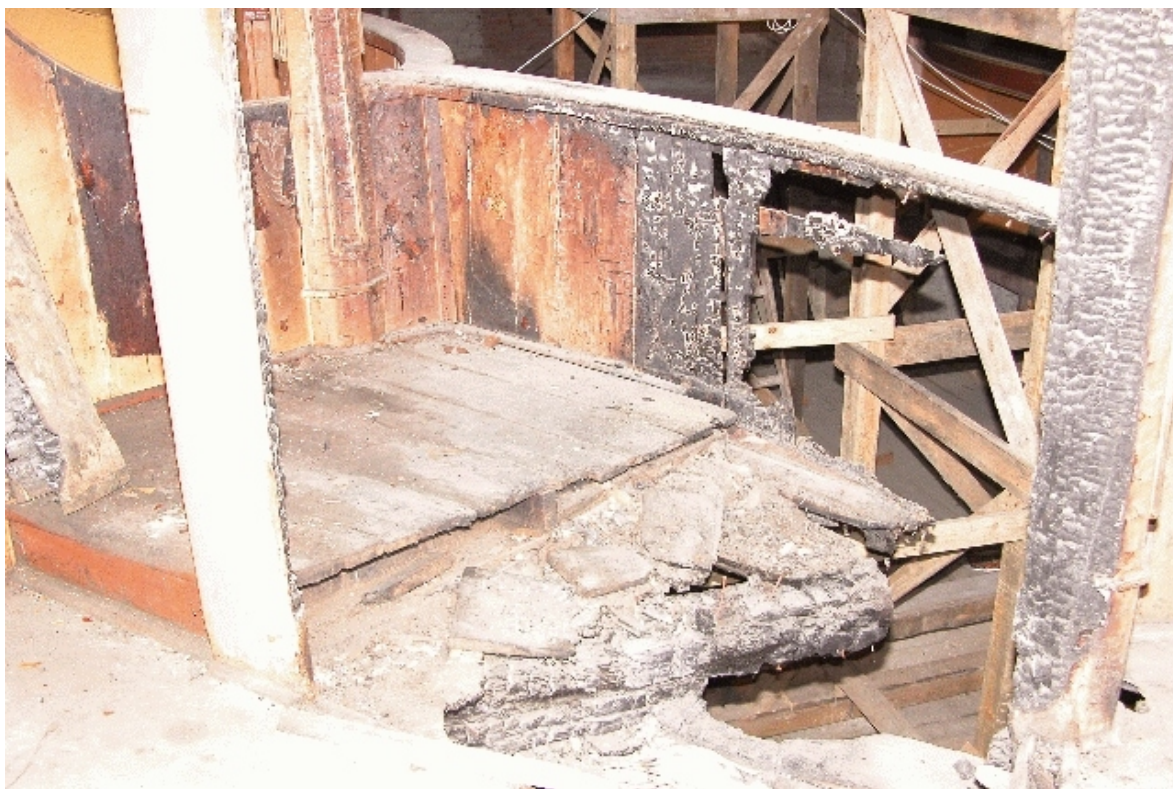
Fot. Nr 74 - Teatr Stary w Lublinie, ul. Jezuicka 18, drewniane loże - II kondygnacja. Spalona loża w trakcie demontażu. .Wyk Małgorzata Podgórska - Makal . 20.08. 2007
