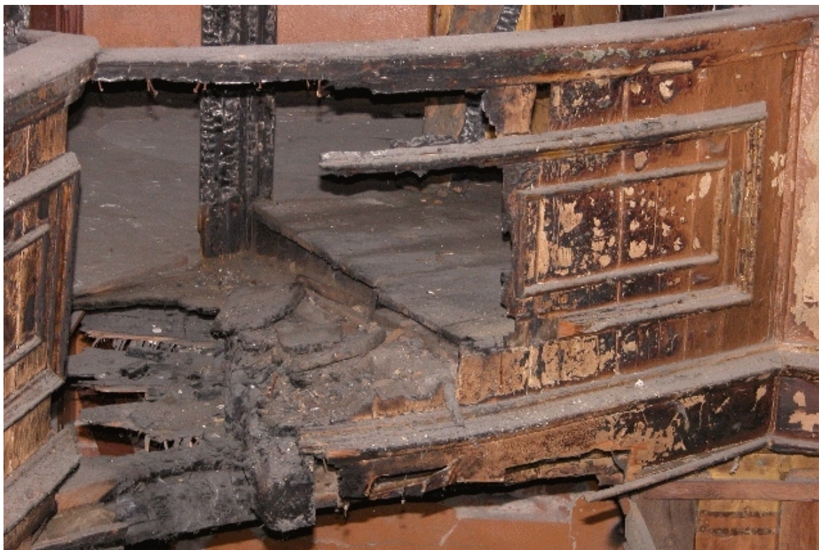
Fot. Nr 25 - Teatr Stary w Lublinie, ul. Jezuicka18,drewniane łóże, stan zachowania przed rozpoczęciem prac rozbiórkowych. II kondygnacja - balkony. Widoczne zniszczenia spowodowane pożarem. Wyk Małgorzata Podgórska - Makal . 03.07. 2007
